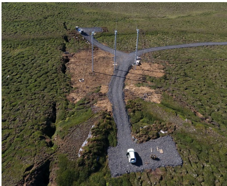
Mynd 6.7 Strengingarplön sitt hvoru megin við stagað hornmastur.
