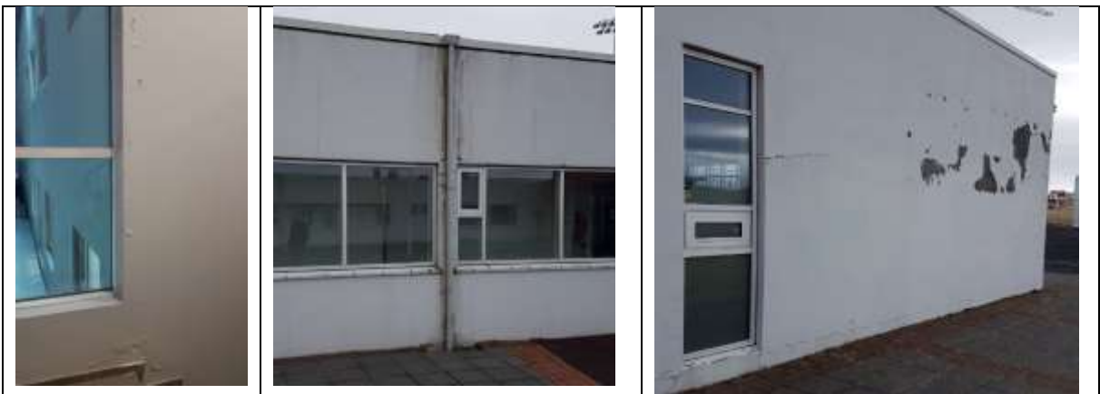
Mynd. Kominn er tími á að laga leka frá gluggum, múr- og sprunguviðgerðir og laga niðurföll.
