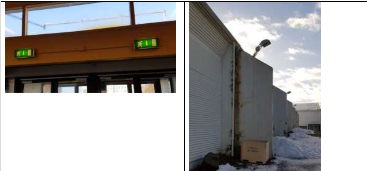
Mynd. Þak á inngangi lekur. Úti þarf að endurnýja rennur, mála og sílanbera hús að utan, sem og laga sprungur í veggjum.
