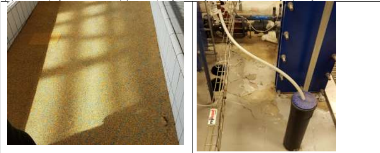
Mynd. Gólfefni þarf að laga/skipta út. Víða þarf að lakka gólf.
