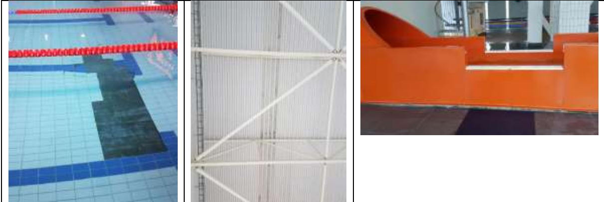
Mynd. Flísar í botni sundlaugar og á gólfi í sal farnar að losna upp. Loftplötur í sundlaugarsal byrjaðar að ryðga. Rennibraut byrjuð að springa við útgang, þarf viðhald og styrkingu.
