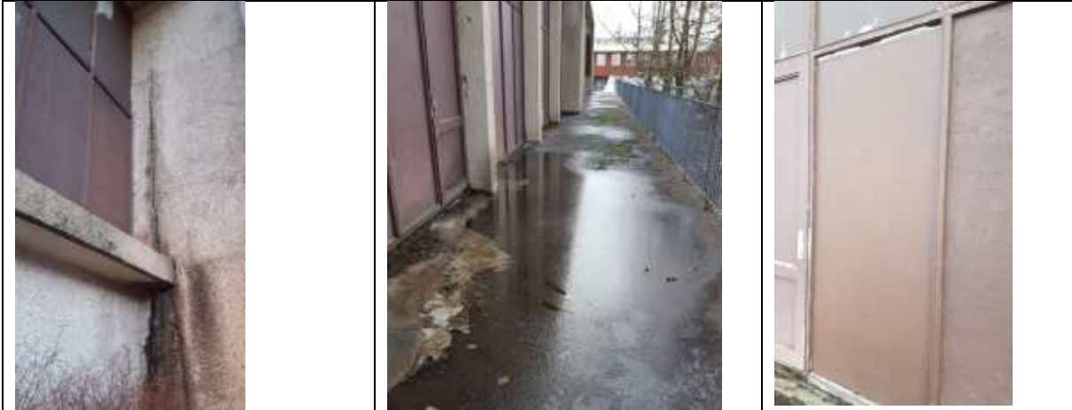
Mynd. Laga sprungur. Skipta þarf út eða breyta gluggaveggjum í íþróttasal. Svalagólf þarf að endurleggja sem og laga flóttaleiðir úr sal.
