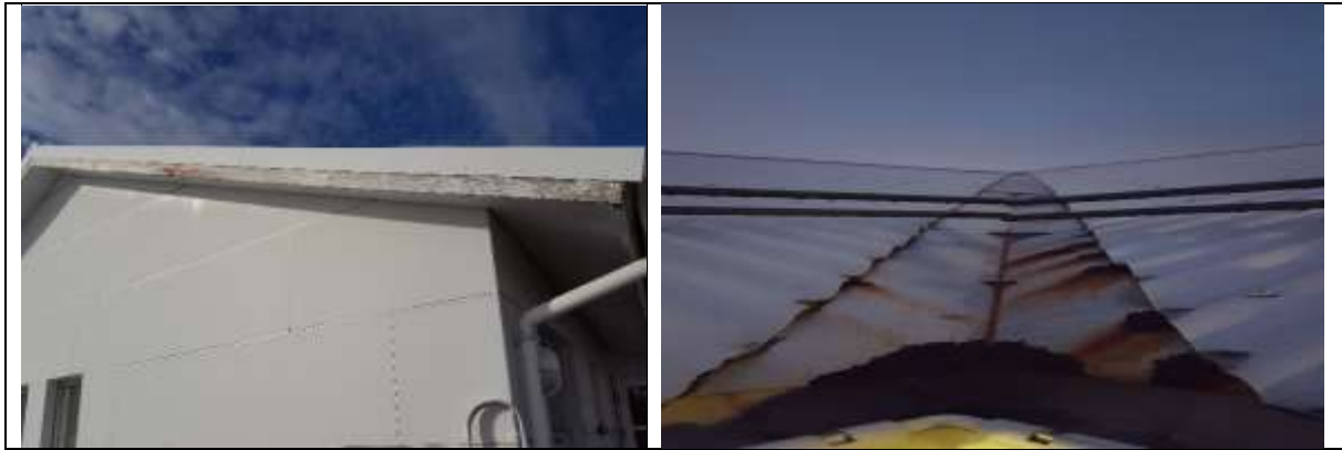
Mynd. Nær öll málning var farin af þakkanti, einnig var kominn fúsi í timbrið á nokkrum stöðum. Í skotrennu er komið mikið ryð.
