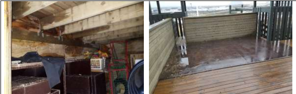
Mynd. Leikfangageymsla undir timburpalli er lek. Að hafa timburgólf sem þak yfir geymslu sem á að vera þurr, er ekki skynsamlegt.
