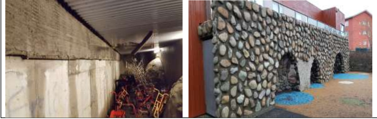
Mynd. Geymsla undir palli austanmegin er lek. Steinklæðning á geymslunni er hrúin af að hluta.
