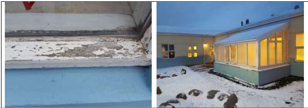
Mynd. Ástand timburglugga var ekki gott og hefði þurft að endurmála fyrir nokkrum árum. Endurmála þarf steypa fleti og setja rennu á viðbyggingu.
