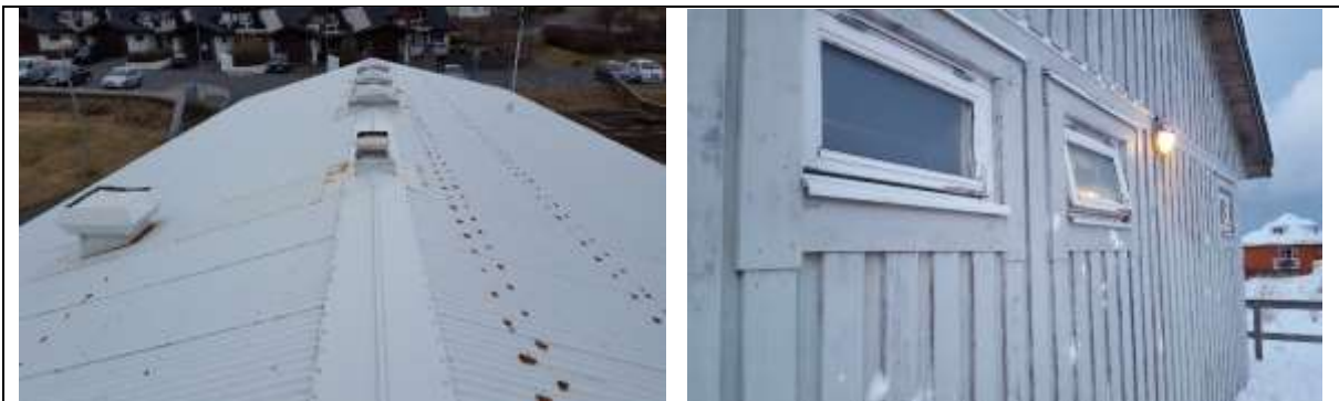
Mynd. Endurmála þarf þakjárn, skipta út festingum og flasningum. Endurmála þarf færanlegar kennslustofur.
