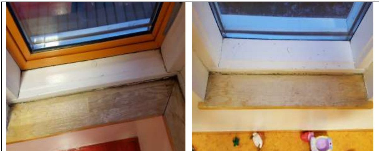
Mynd. Gluggar eru búnir að vera lekir í nokkur ár og skemmdir innanhúss eftir því.
