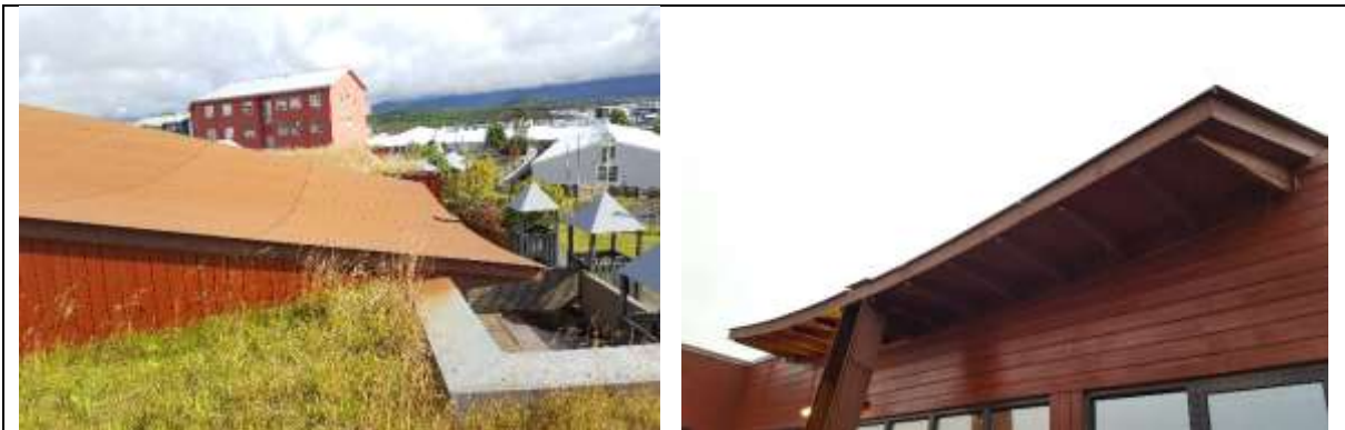
Mynd. Regnvatnsrenna annar ekki vatnsmagn frá þaki. Vatn sem skilar sér niður rennuna safnast fyrir á lóðinni og þar myndast tjörn sem er hættuleg fyrir börnin.
