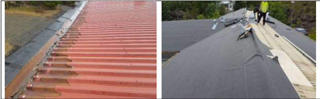
Mynd. Þakjárn orðið töluvert ryðgað, sem og rennur. Krossviður var heilt yfir í góðu standi.
