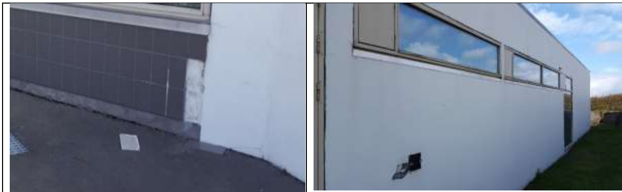
Mynd. Veggflísar utanhúss byrjaðar að losna. Lagfæra þarf sprungur í steypum veggjum og gera við skemmdir.
