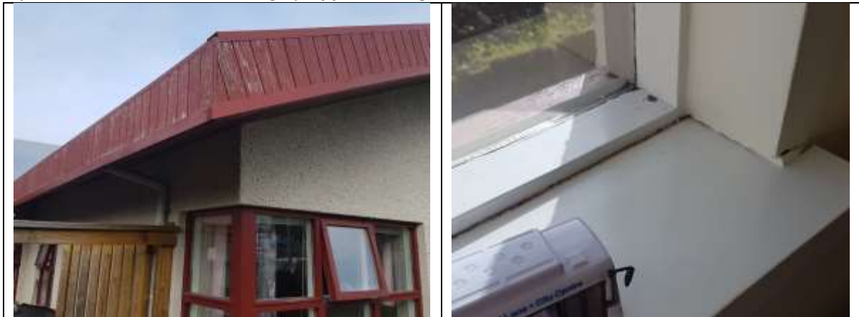
Mynd. Mála þarf tréverk reglulega á húsinu. Laga þarf glugga að innan á nokkrum stöðum
