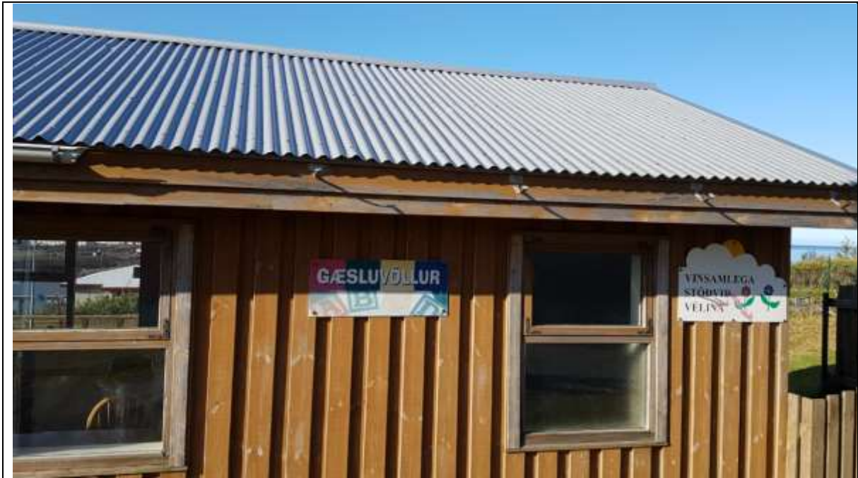
Mynd. Bera þarf á allt tréverk utan á húsinu, sem og laga rennur.
