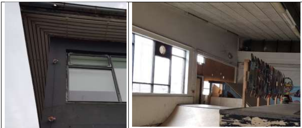
Mynd. Tréverk víða illa farið og rennur og niðurföll komin á tíma. Að innan þarf að mála gólf og vegg
