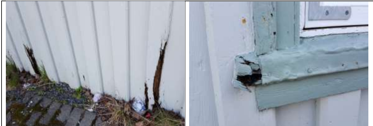
Myndir. Endurnýja þarf klæðningu að hluta vegna fúa.
