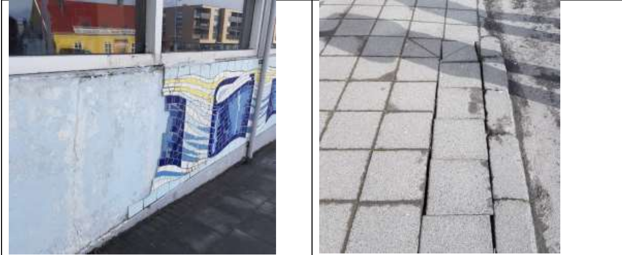
Myndir. Listaverk er illa farið á húsvegg. Lagfæra þarf hellur og ljósbúnað á lóðinni.
