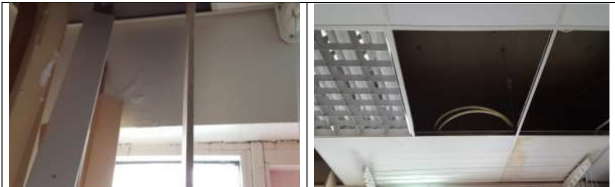
Mynd. Í þvottahúsi eru raka og lekavandamál, ummerki bólgín málning. Gera þarf endurbætur innanhúss þegar búið er að koma í veg fyrir leka og raka.
