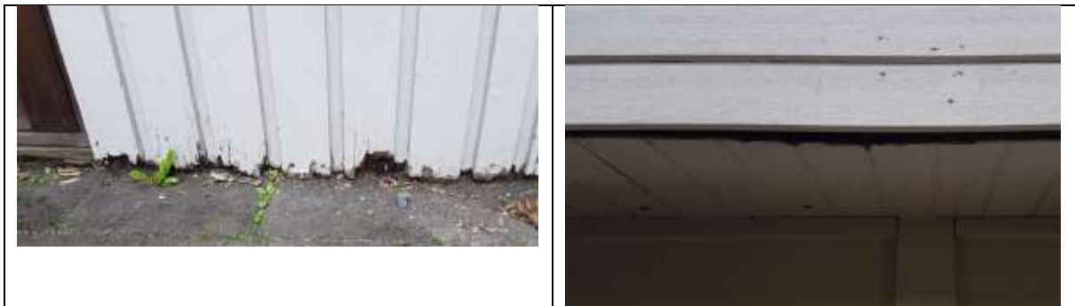
Mynd. Laga þarf fúa í tréverki að utan. Laga þarf rennur og þakkant.
