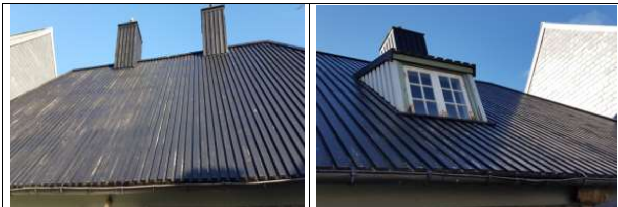
Myndir. Kominn er tími á að endurmála þak og lagfæra rennur. Timburklæðning er töluvert sprungin á framhlið hússins.
