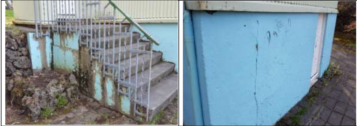
Mynd. Gera þarf við steypuskemmdir.
