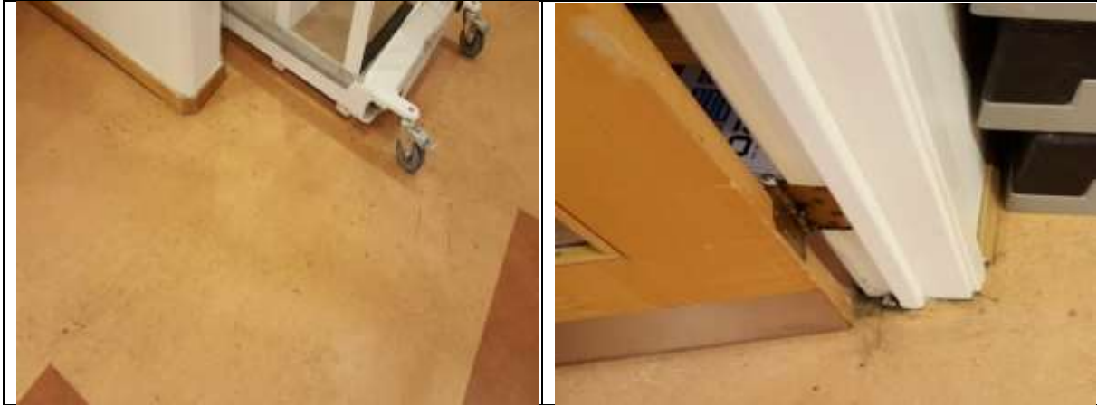
Mynd. Gólfdukur er orðinn lélegur og erfitt er að þrifa dúkinn. Yfirfara þarf hurðir.
