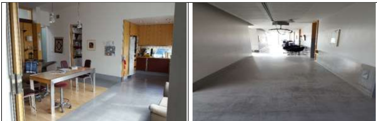
Mynd. Parket þarf endurlakka og bóna gólfduka. Endurmála þarf vegg, glugga og hurðarkarma.
