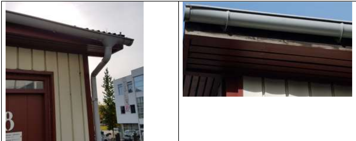
Myndir. Laga þarf rennur og mála þarf þakkant.
