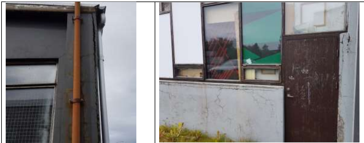
Mynd. Ráðast þarf í umtalsverðar sprunguviðgerðir
