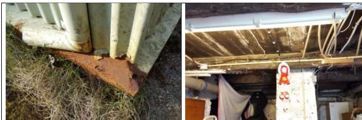
Mynd. Botnstykki og klæðning farin að ryðga. Í kjallara er rakavandamál og ummerki sýnileg á timburborðum og burðarbitum.
