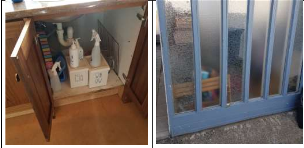
Mynd. Léleg eldhúsinnrétting í húsinu. Gafl við inngang er fúinn.
