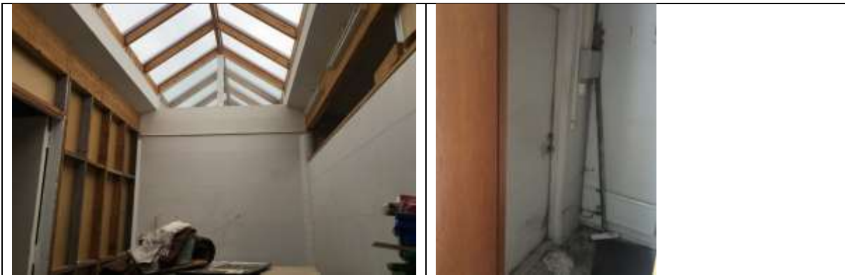
Myndir. Setja þarf á ný gólfefni, veggj þarf að laga og mála. Rafmagn og pípulagnir þarf að endurskoða. Húsið í mikilli niðurniðslu, þarf að þrifa hús að innan og henda miklu drasli.
