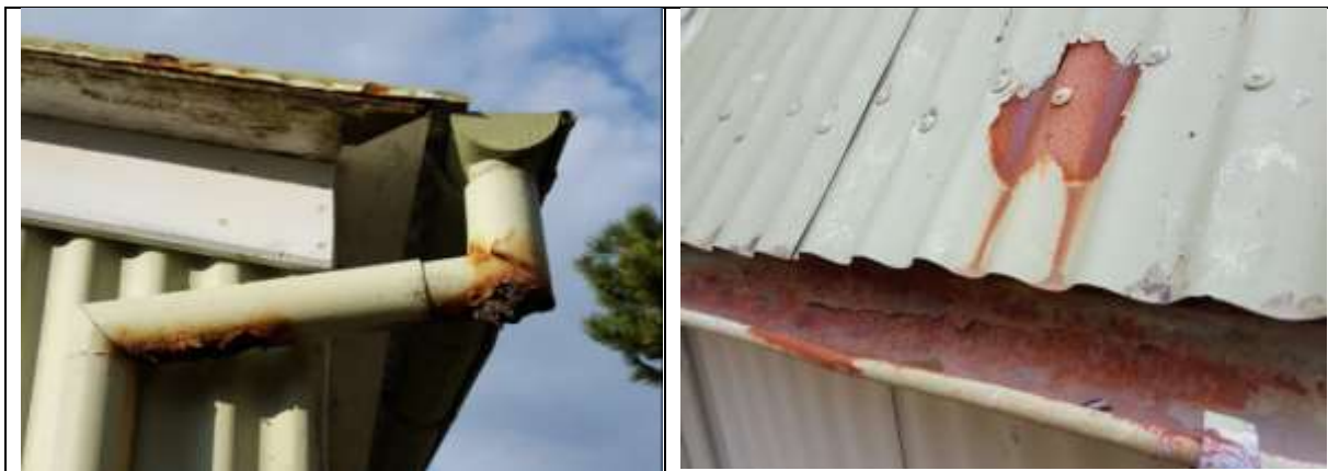
Mynd. Rennur og niðurföll þarf að endurnýja. Ryð komið í þakjárn og flasningar.
