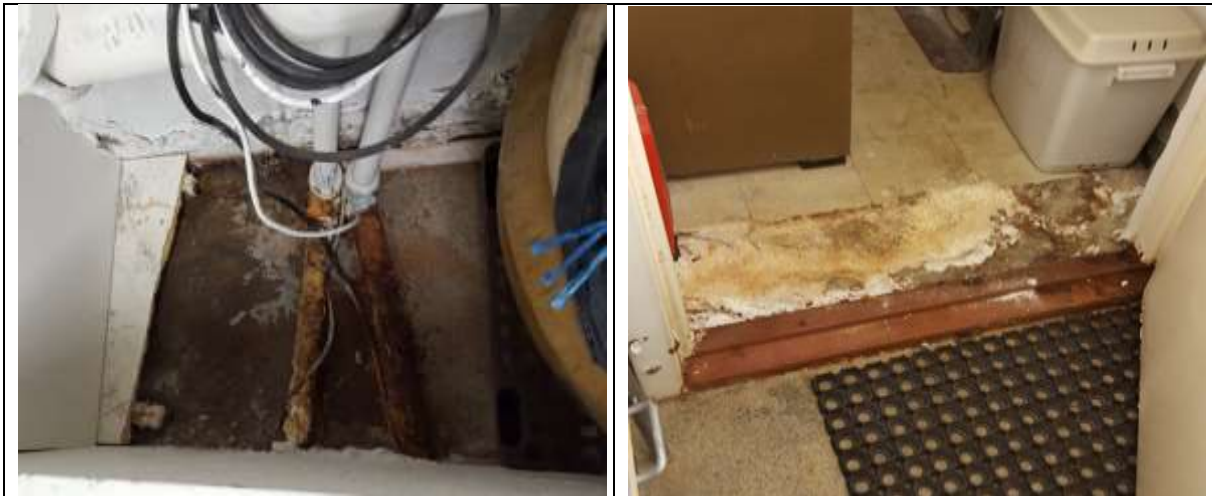
Mynd. Í kjallara þarf að skoða ástand lagna. Gólfefni í kjallara þarf að yfirfara.
