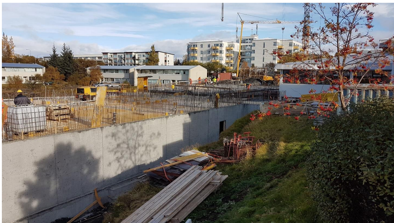
Vettvangsmynd fundardag. (Unnið við undirslátt undir plötu yfir kjallara, horft frá vesturenda til austurs.)
