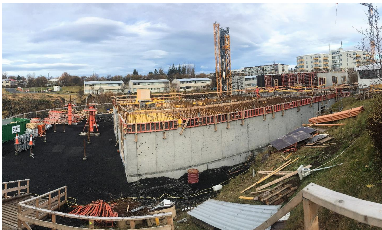
Vettvangsmynd fundardag. (Unnið við uppsteypu súlna og járnþöngu plötu yfir kjallara, horft til austurs.)
